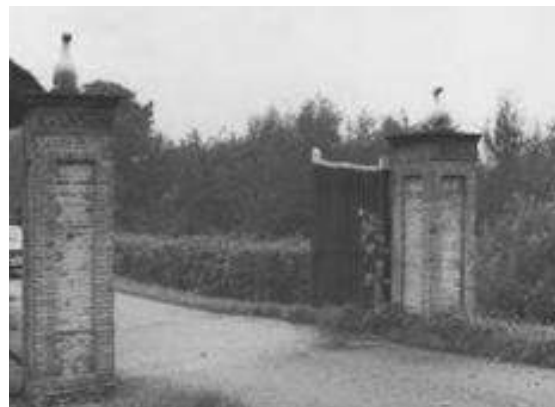
De hekpijlers van boerderij 'Gansen Burgh' aan de Provinciale weg Oost 83 te Haastrecht (foto RDMZ, 1977).
